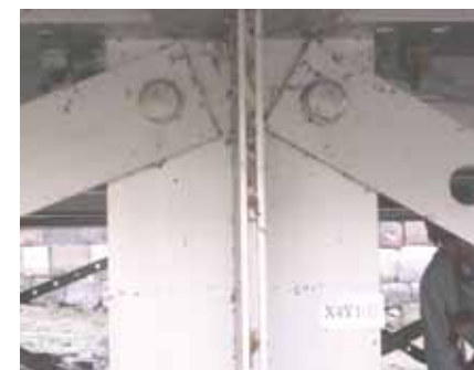
柱脚の筋交い接合部。ディスゴ処理を施したステンレス鋼ボルトを用いたため、軽微な赤錆が生じたのみ。
