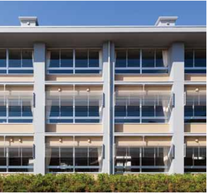
景観を損なわず直射日光を遮るアルミルーバー。
