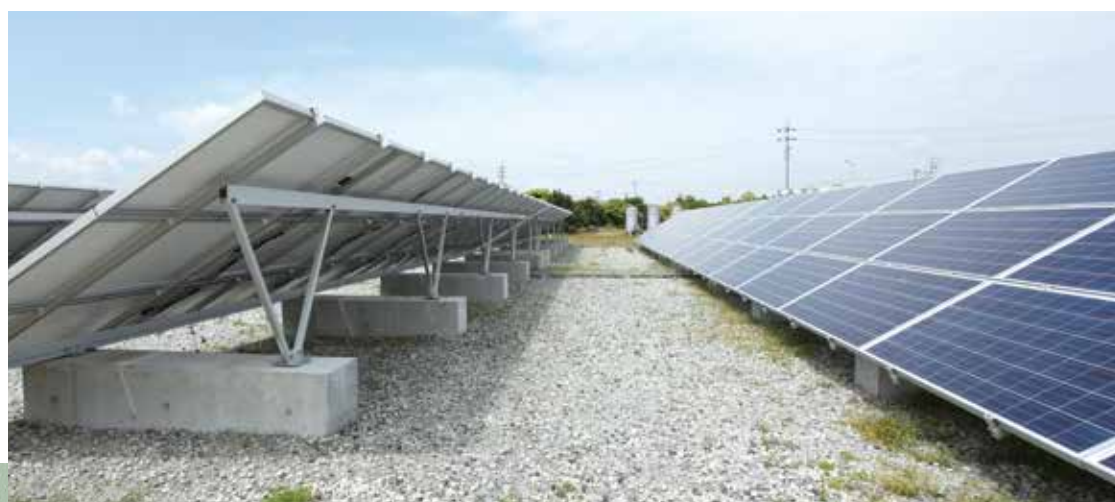
太陽光パネル架台
